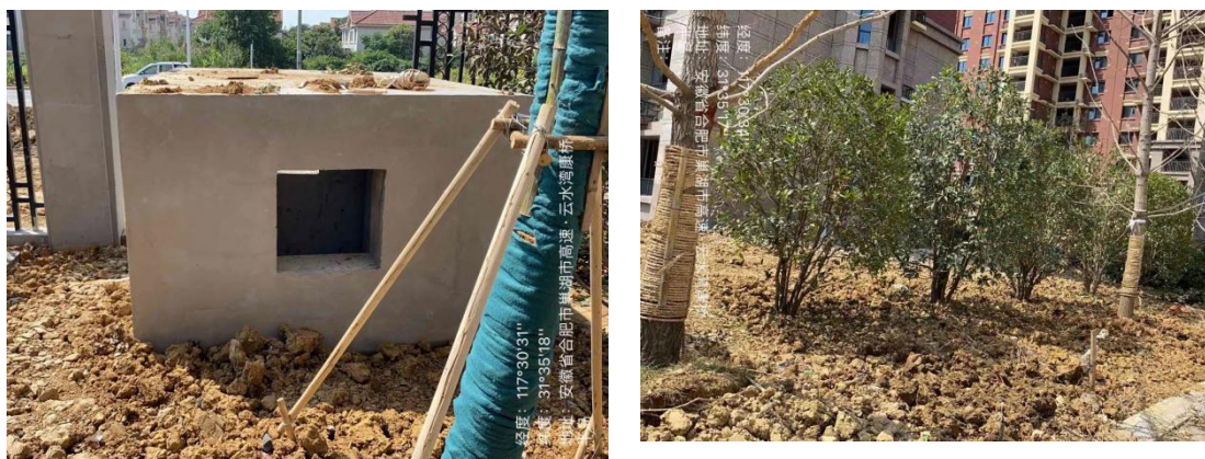
车库汽车尾气排放口
