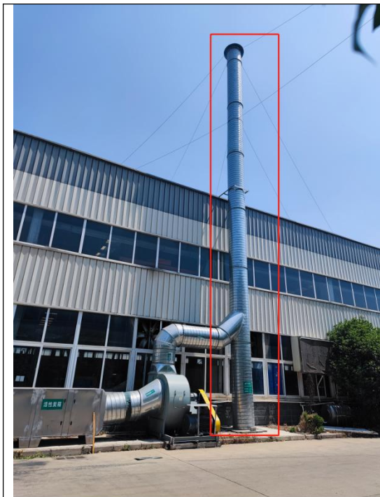
熔融挤出废气排气筒
