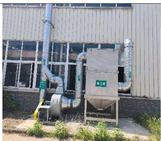
破碎粉尘废气布袋除尘器设施
